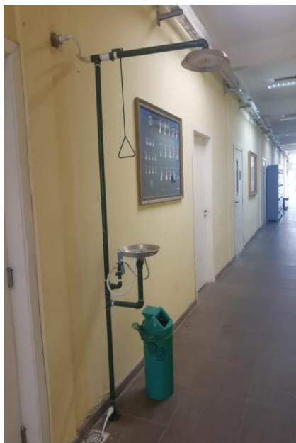
Figura 4. Chuveiro de emergência e lava-olhos instalado nas dependências da Biotecnologia do Centro de Desenvolvimento Tecnológico da Universidade Federal de Pelotas.
